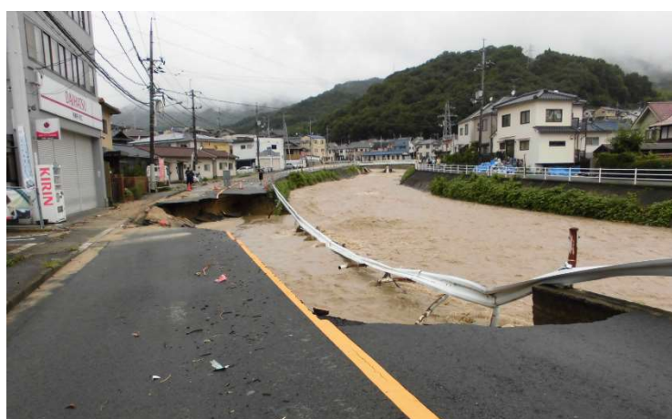
図-10 平成 30 年 7 月豪雨における被災状況
